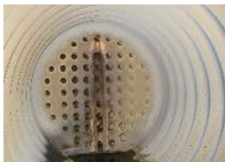
▲煙管の割れ (炉筒煙管ボイラー)
