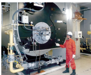
▲ボイラー性能検査
